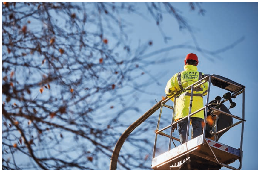
VALORE AGGIUNTO DI CITY GREEN LIGHT È LA "VICINANZA" CON L'ENTE LOCALE, CHE PERMETTE DI DARE RISPOSTE E INTERVENIRE CON ESTREMA TEMPESTIVITÀ
