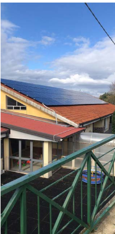
A QUESTO PRIMO IMPIANTO FOTOVOLTAICO NE SEGUIRANNO ALTRI CINQUE CHE SARANNO INSTALLATI SU ALTRETTANTI EDIFICI DI PROPRIETÀ COMUNALE
