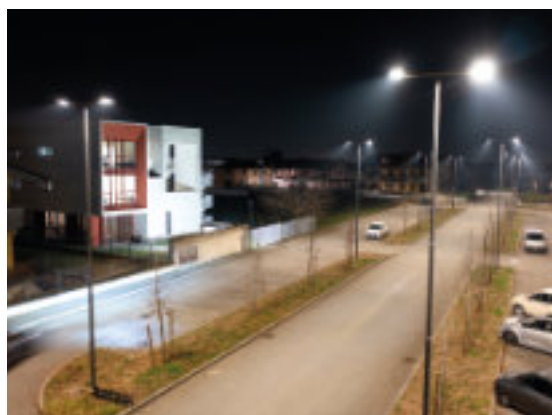
IL PROGETTO HA PORTATO ALLA SOSTITUZIONE DI CIRCA 3.000 APPARECCHI CON SORGENTI A VAPORI DI SODIO E MERCURIO CON SOLUZIONI LED AD ALTA EFFICIENZA
